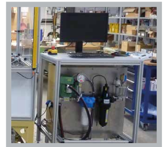
带操作台的水处理装置
